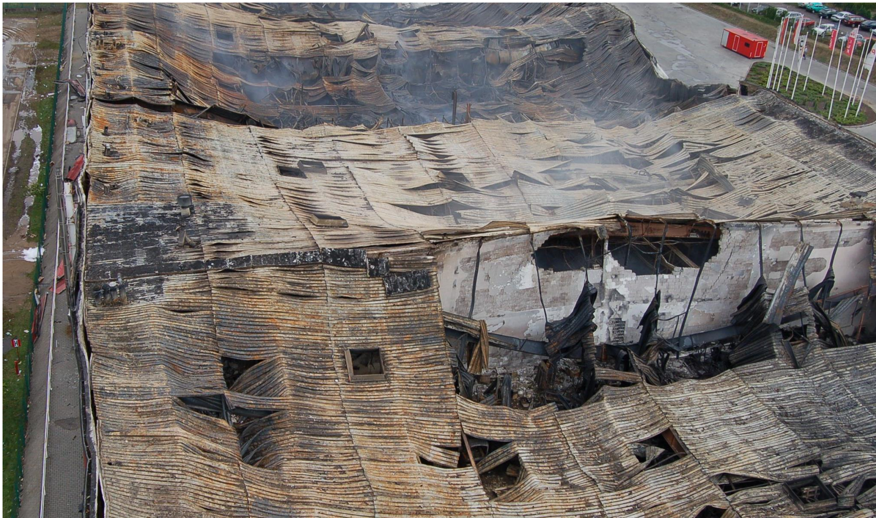
Pożar obiektu magazynowego (źródło T. Wiśniewski)
